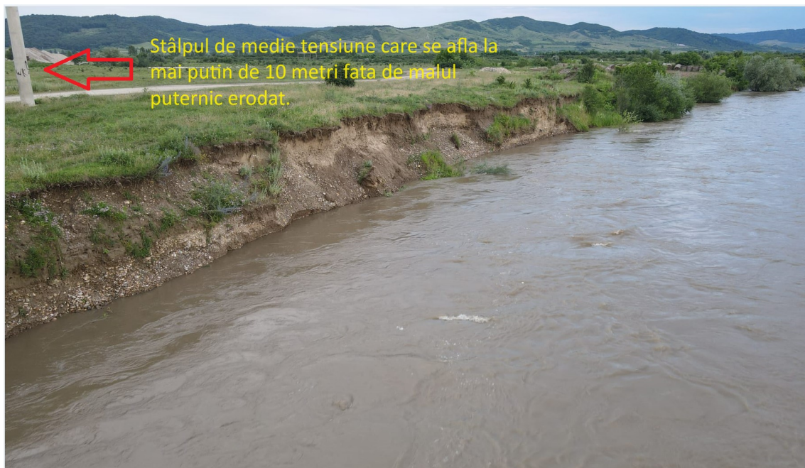
Fig. 16. Malul stâng al râului Arieș în zona analizată este intens erodat
