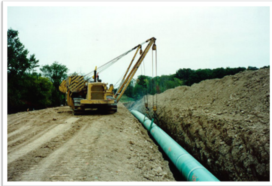
Figura 1.6.2.2.-2 Prezentare a modul de lansare a unei conductei de transport gaze naturale în șanț
