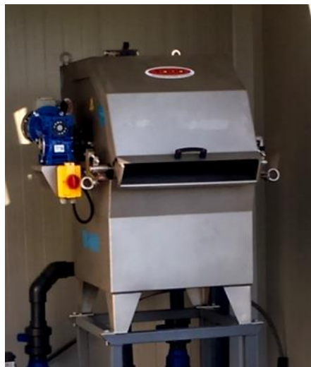
Figura 12. Instalatia automata de sitare
