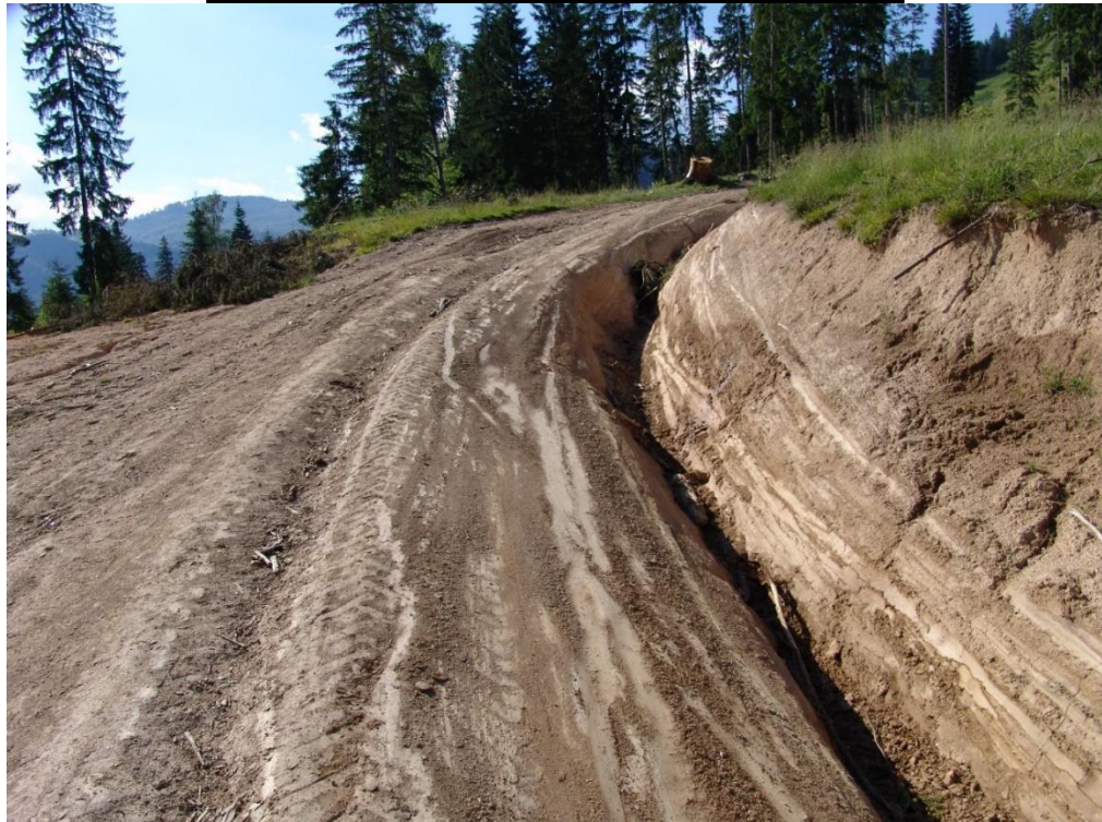
Figura 80. Ilustrarea impactului asociat unui drum forestier de exploatare; se observă ogașele profunde cauzate de fenomenele erozive, tasările generate de târârea arborilor și zonele extinse de afectare ca urmare a insuficientei pregătire a zonelor de schimbare a direcției
