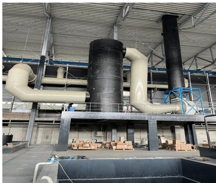
Figura nr. 5. Linia de pretratare chimică – scrubber spălător, coș dispersie cod A1
