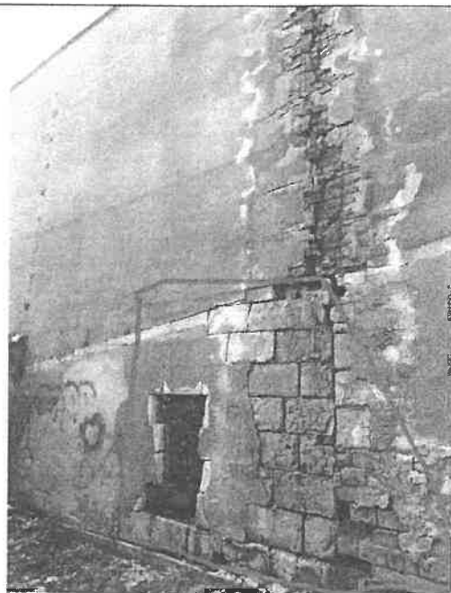
Fațada posterioară. Zidărie exterioară BCA (în stânga) și din cărămidă plină (dreapta)
