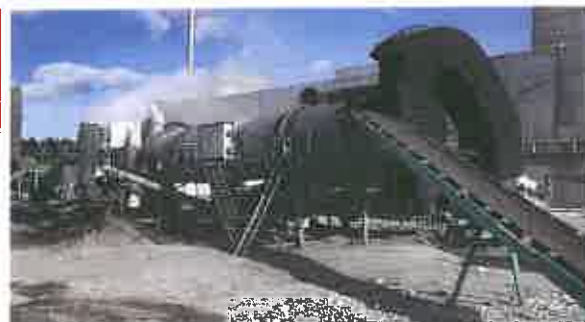
Figura 10. Instalația de desorbție rotativă
