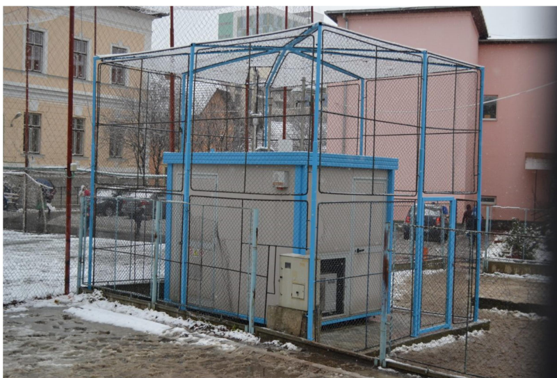
Figura I.4.2. Stație automată de monitorizarea calității aerului de tip urban.
